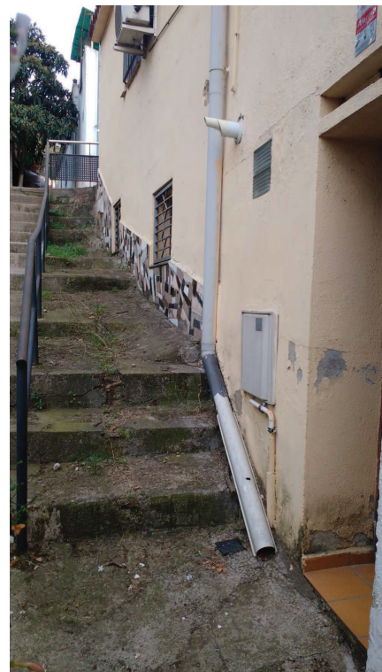
F5. Imatge general del carrer del Vent per sota del carrer París. S'observa com els baixants pluvials dels habitatges efectuen la evacuació de forma directa al carrer. Es proposa la connexió d'aquests baixants a les noves reixes de recollida. Per altra banda la proposta té en compte la cota d'accés dels diferents habitatges a l'hora de millorar la seva accessibilitat, a la vegada que s'evita l'entrada d'aigua pluvial que discorri pel carrer.
