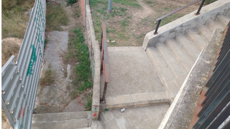
F1. Imatge de l'inici del carrer del Vent en la intersecció del carrer Simeó Garcia. S'observa com existeix un tram d'escala final en bon estat, el qual no és objecte de modificació. Per altra banda, però, aquest tram final ofereix un recorregut irregular i poc lineal. Es proposa allargar el graonat de l'escala final en bon estat fins connectar en angle recte amb la nova proposta de millora del carrer del Vent.
