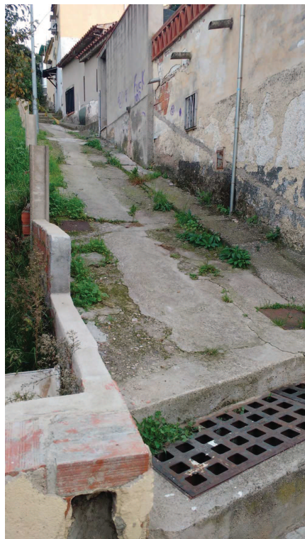
F6. Imatge del tram final del carrer del Vent, en la seva intersecció amb el carrer Sant Andreu. S'observa com existeix una canal de recollida pluvial connectada a la xarxa pública, però amb dimensions i característiques no aptes pels criteris d'accessibilitat. Es proposa la seva substitució. S'observa la forta pendent del carrer, el qual es proposa resoldre amb un graonat ordenat seguint el mateix perfil longitudinal general.
