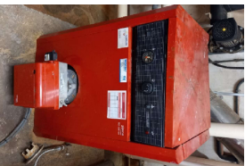
C1 - CALDERA DE GASOIL EXISTENT PER ACS
