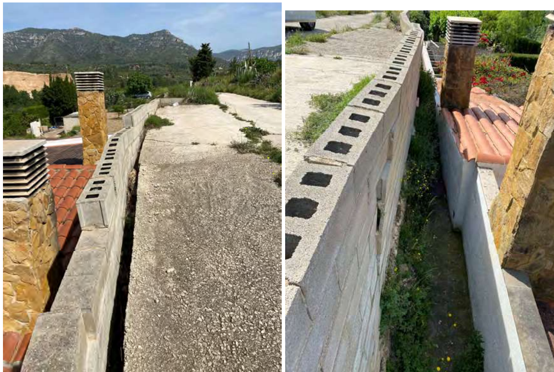
Imatge 1. Vista de la fallada estructura del mur de contenció del Batanet.
