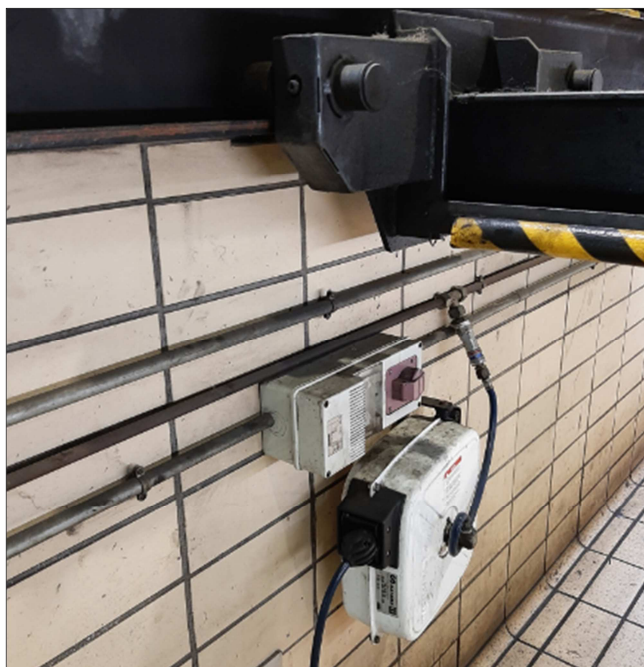
Fotografía 7. Instalaciones presentes en foso
