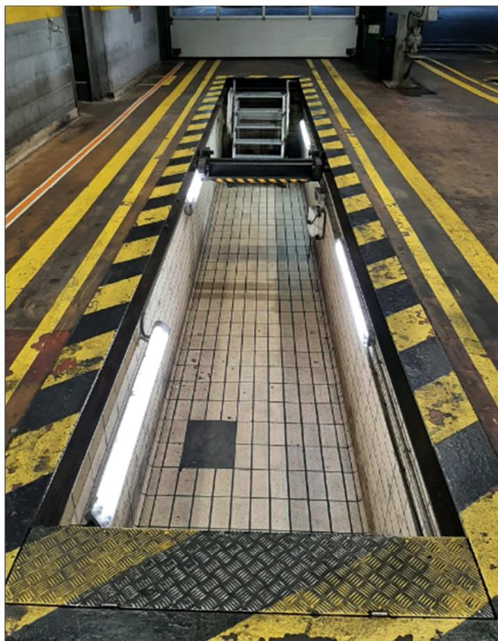
Fotografia 4. Estado actual Foso (1)
