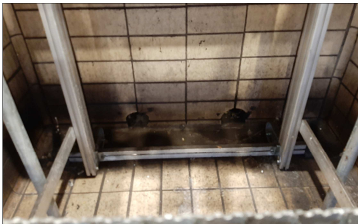
Fotografía 9. Ubicación de puntos de drenaje
