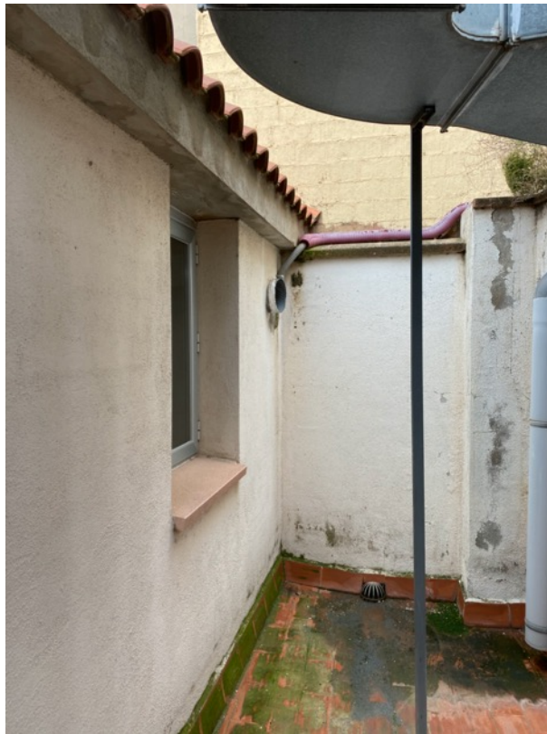
Imatge 7: ubicació de la baixada del cablejat de terra fins al recinte d'escomesa
