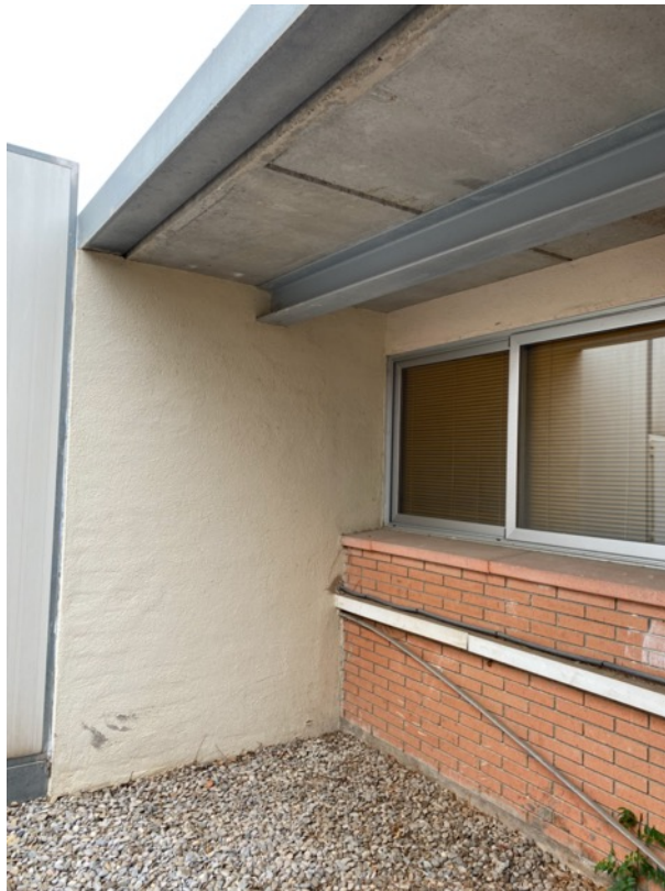
Imatge 5: Ubicació inversors 2 i 3a sota de la coberta de xapa de l'edifici Annex
