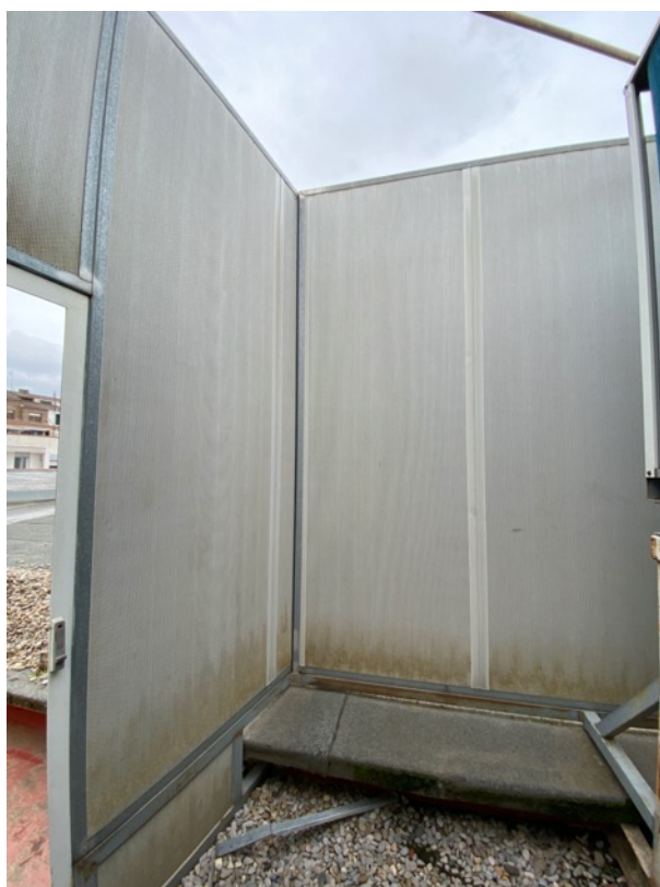
Imatge 9: Ubicació inversor 1
