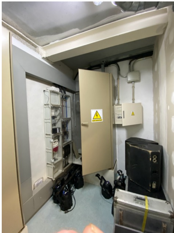
Imatge 6: Recinte d'escomesa del centre
