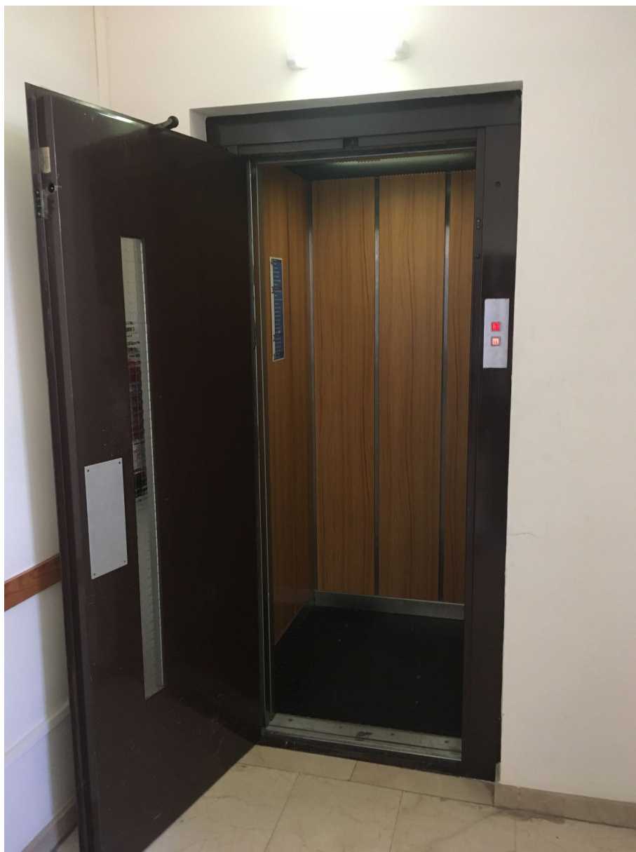
Accés Cabina Ascensor 06
