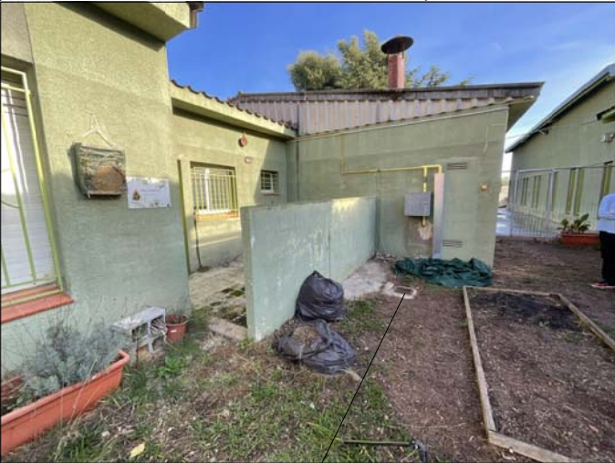
FAÇANA SUD AMPA. IMBORNAL EXISTENT
