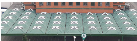
Marquesina de Zona productors Locals, amb línia de vida
