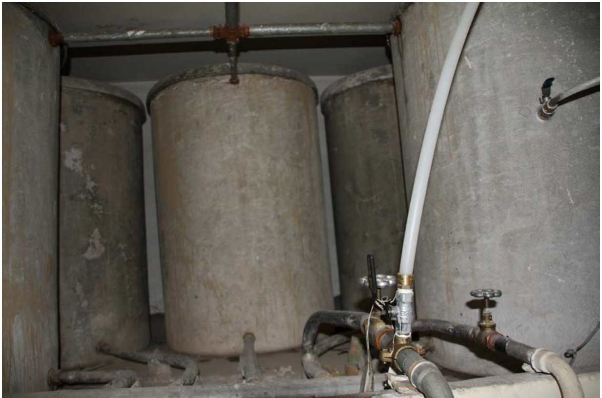
Dipòsits de aigua de fibrociment a altell planta setena, a eliminar
