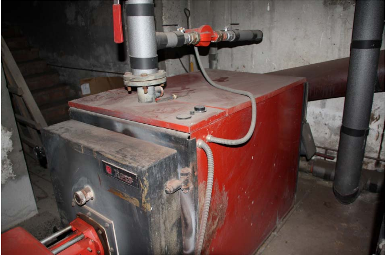
Calderes de gas-oil a substituir
