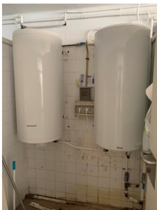
Instal·lació actual ACS
