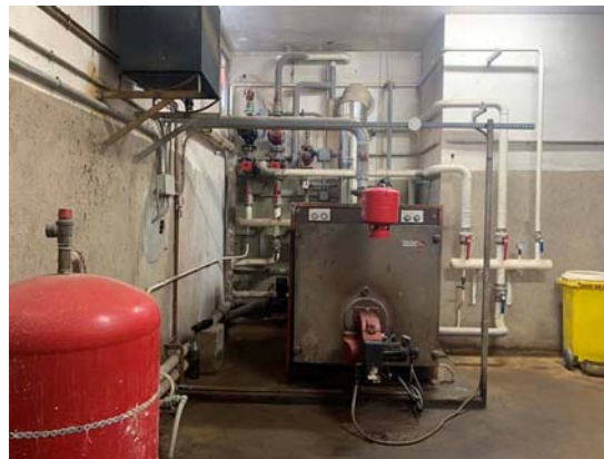
Instal·lació de calefacció actual
