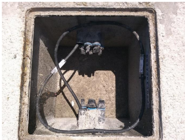
Exemple de pas de cable per pericó
