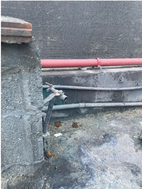
Figura 8. Punt d'alimentació aigua existent
