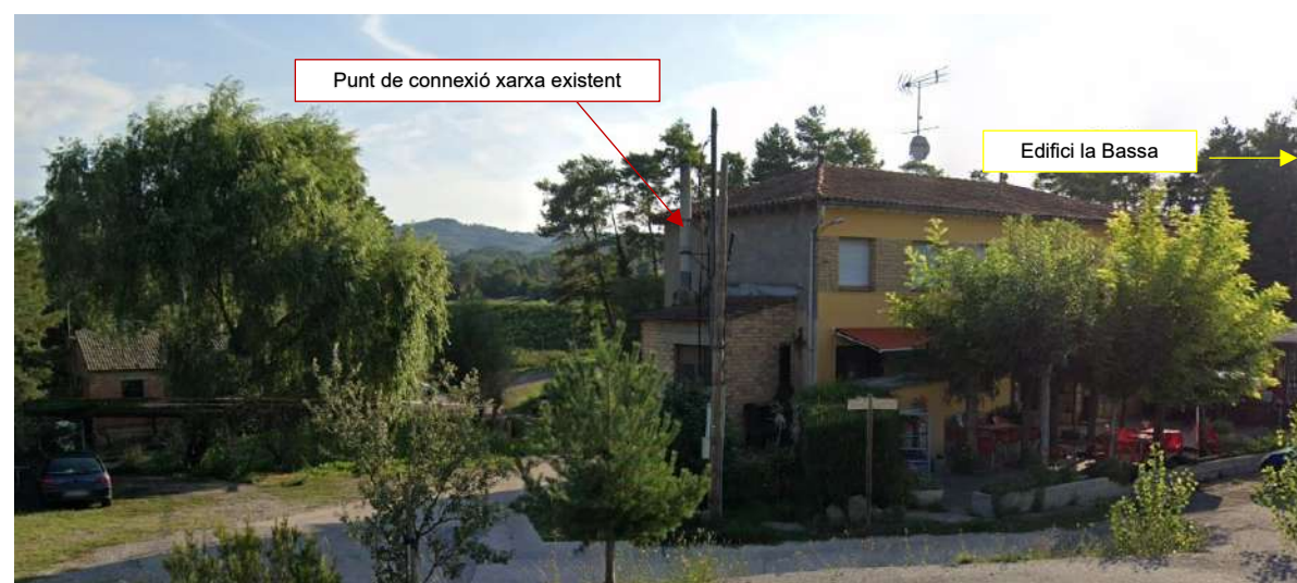
Punt de connexió existent (pal de fusta)
