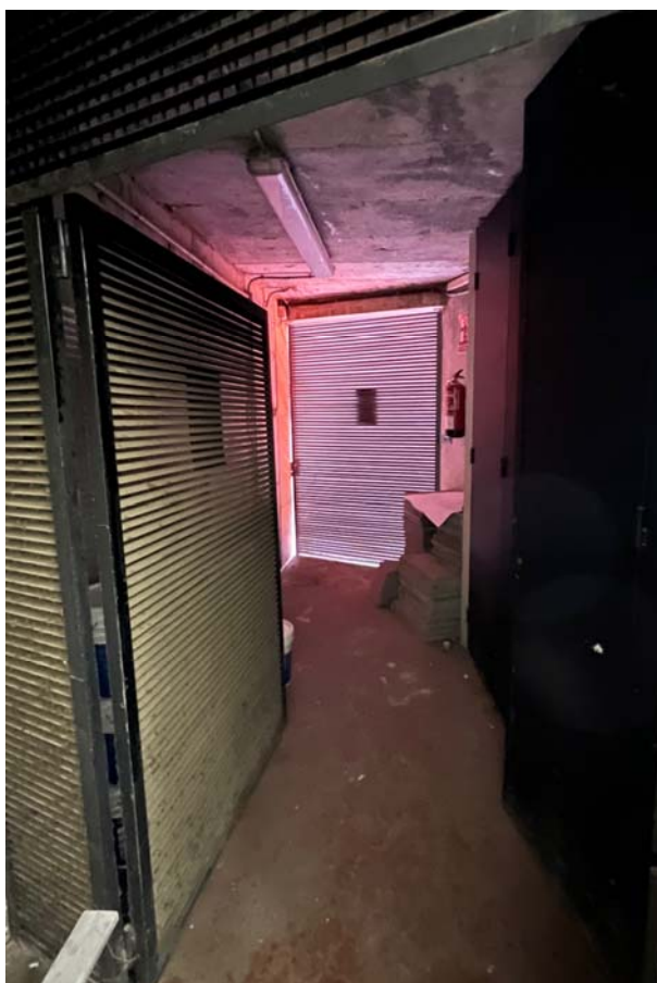
Accés a cambra de calderes
