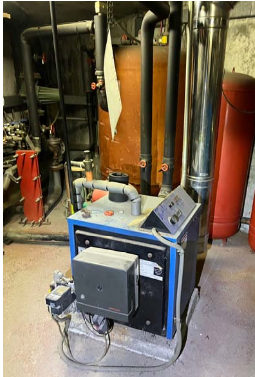
Caldera 3 i acumulador acs fora d'ús.
