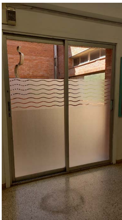
Fusteria P1 a substituir
