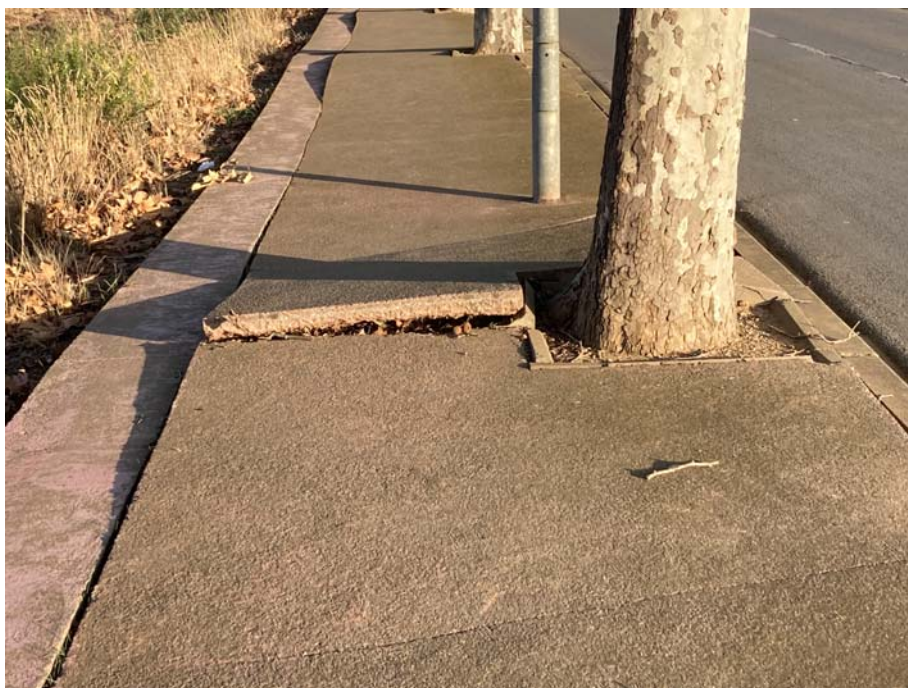
Vista de l'estat actual de la vorera amb el paviment de formigó aixecat
