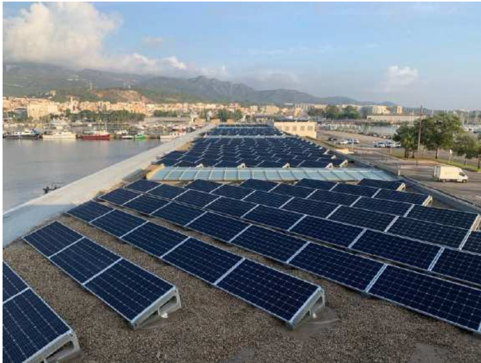
Ejemplo instalación con estructura lastrada sobre cubierta
