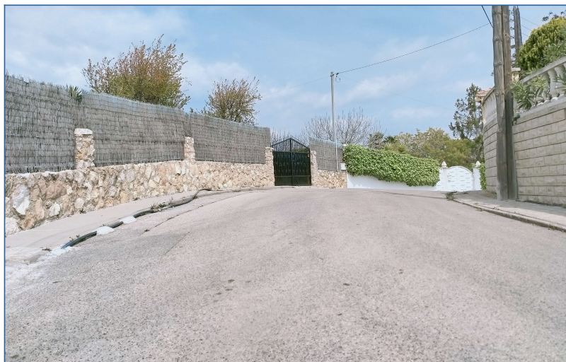
Imatge 8. Tub sense soterrar al carrer Llobregat
