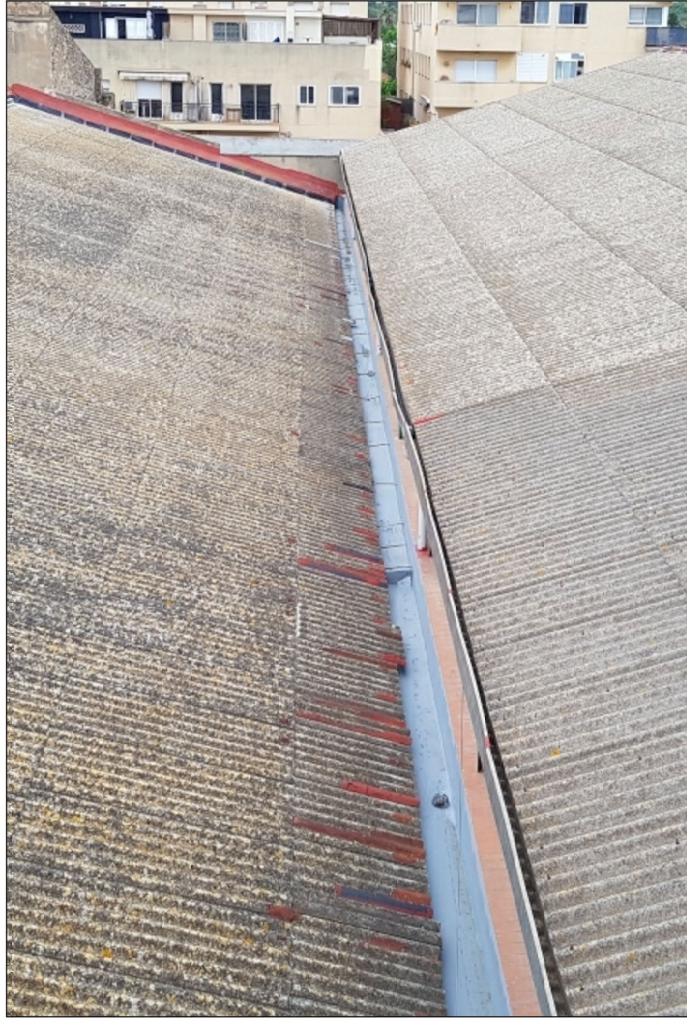
CANAL RECOLLIDA D'AIGÜES PLUVIALS DE LA VESSANT NORD DE LA COBERTA
