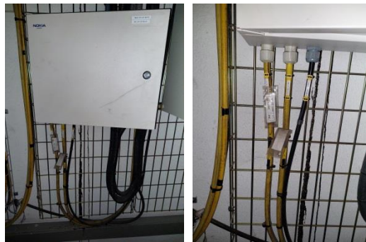
Situación actual de repartidor en CCP
