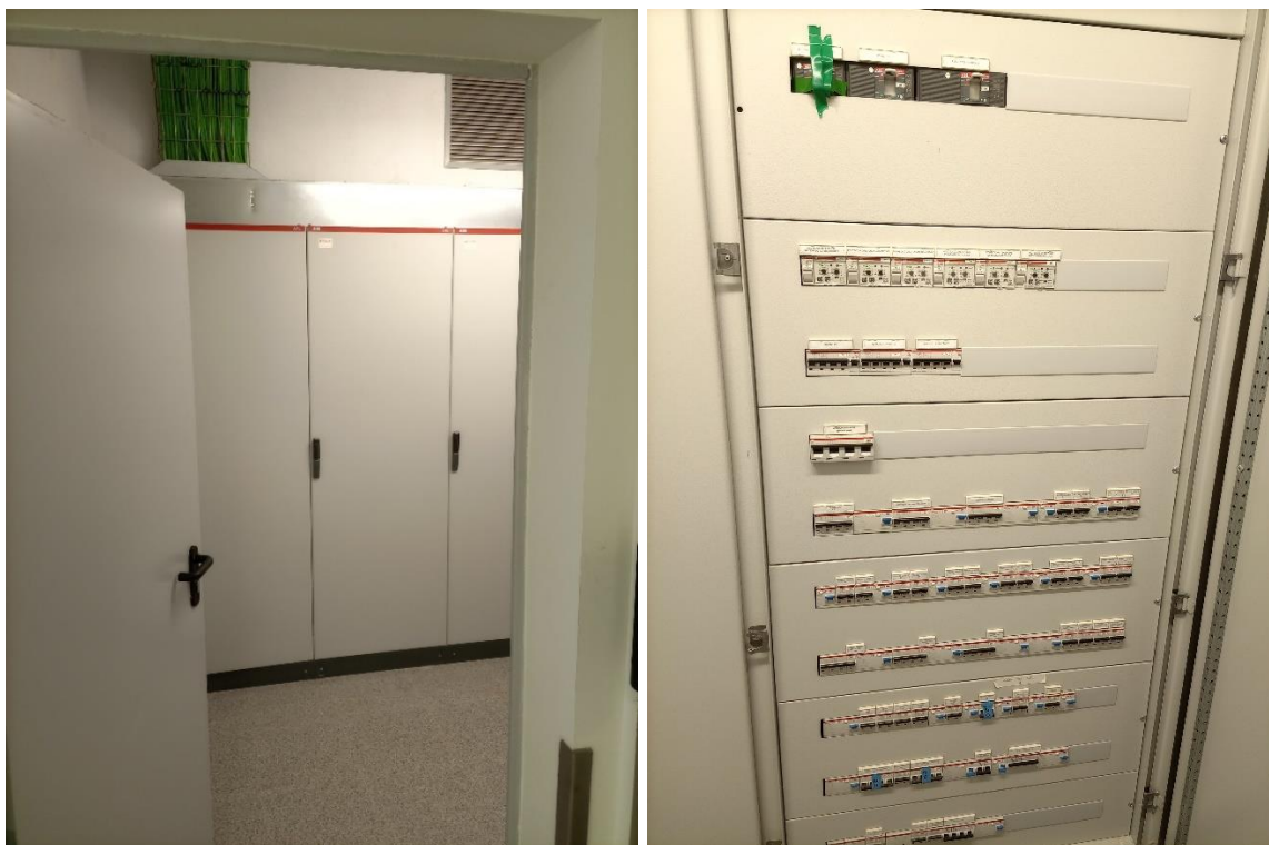
Fig. 14 Sala tècnica on s'ubica el QGBT de l'edifici i rack de comunicacions
