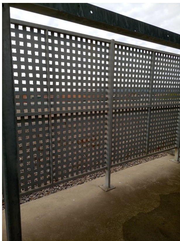
Fig. 13 Vista de zona d'instal·lació de l'inversor i quadre de proteccions
