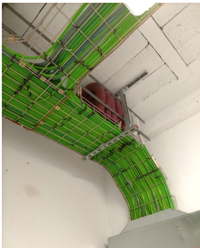
Fig. 15 Safata existent amb cablejat a sala tècnica
