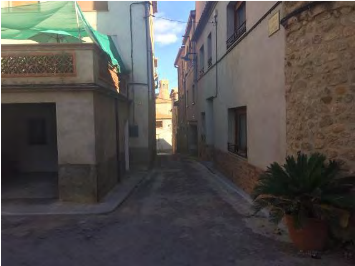
Vista del carrer Marià Llanera, mirant cap al nord, on es poden veure el mal del paviment i els baixants que evacuen directament al carrer
