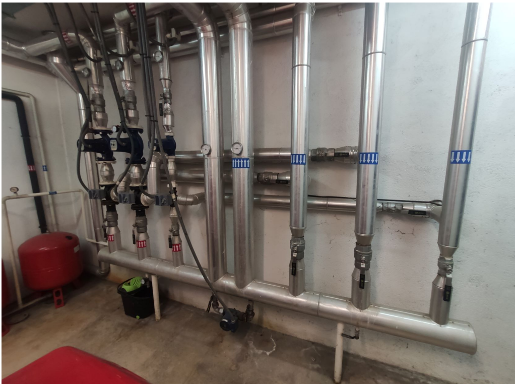
Interior sala de calderes
