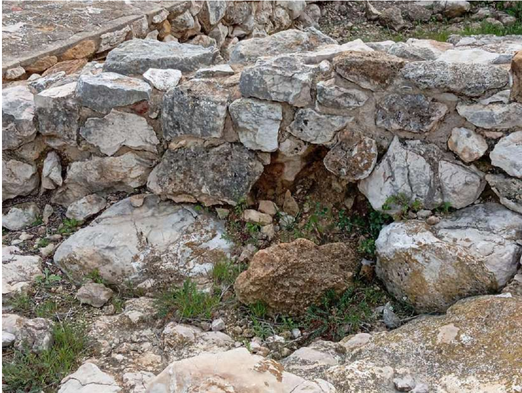
Un altre exemple de la degradació de les filades inferiors de les estructures originals
