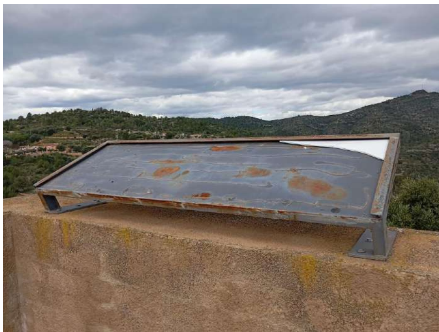
Vista d'un dels plafons informatius de la torre T3, on s'hi pot observar el seu estat de degradació extrema.
