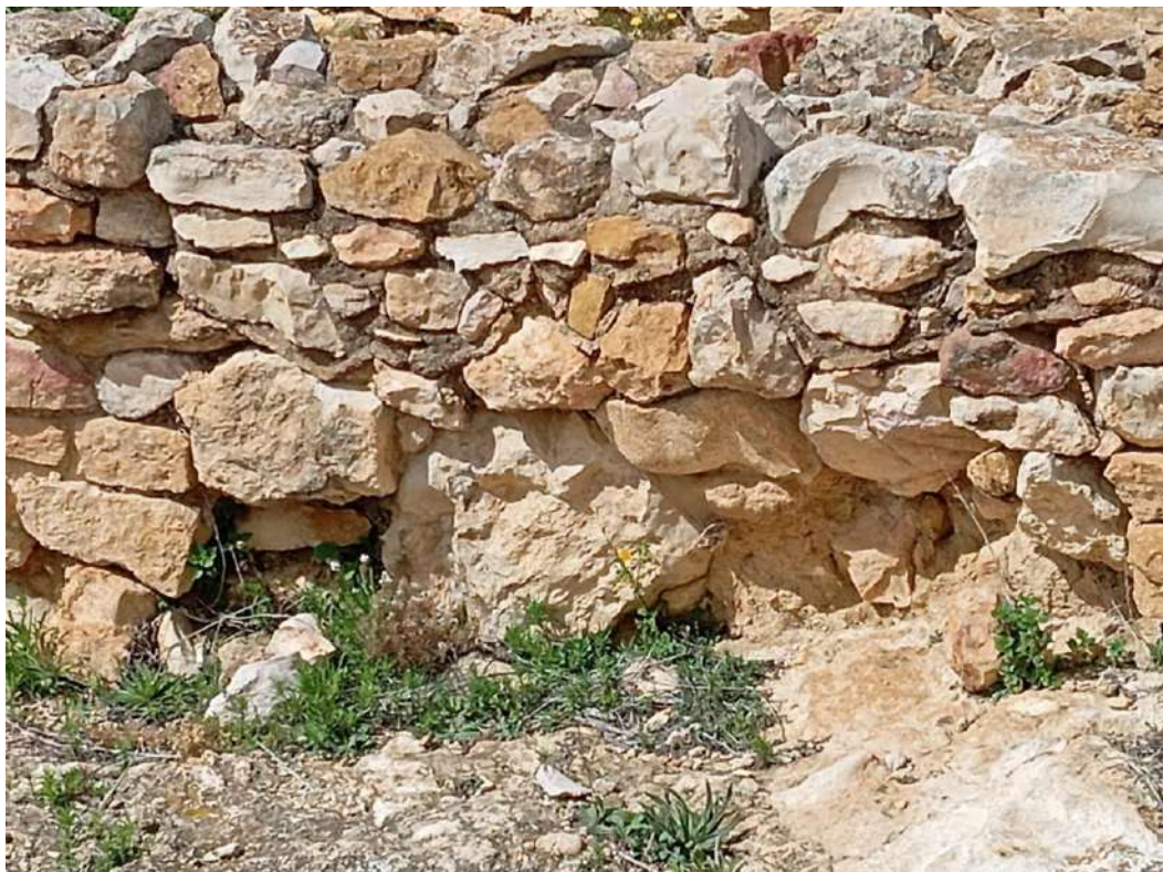
Vista, a manera d'exemple de l'estat de degradació de la base d'un dels murs arqueològics del poblat. La pèrdua notable del suport petri a la base dels murs genera un perill imminent de col·lapse de l'estructura original
