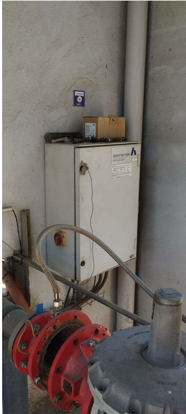
Il·lustració 10 Panell elèctrica torxa Hofstetter
