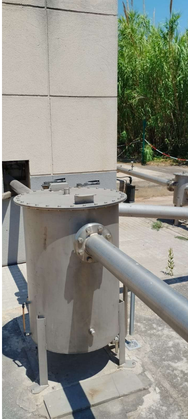
Il·lustració 11 Filtre de condensats previ a les torxes
