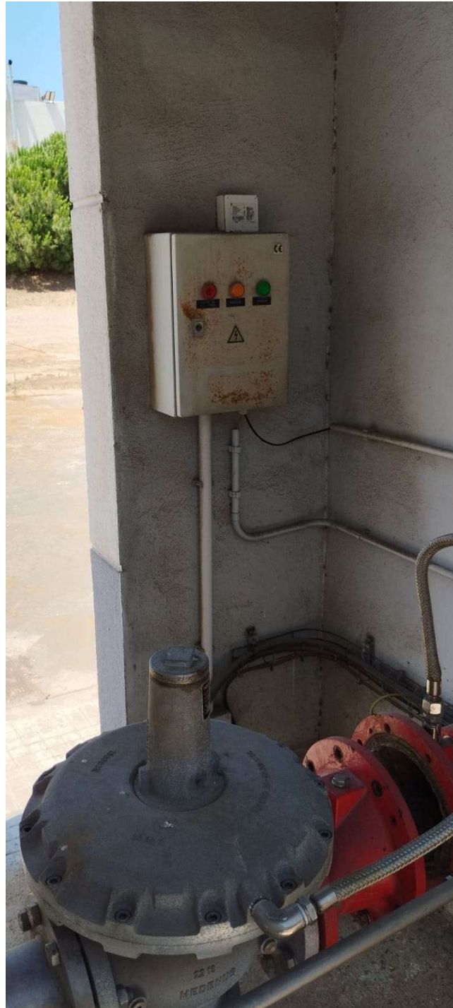
Il·lustració 6 Panell elèctric torxes Groth
