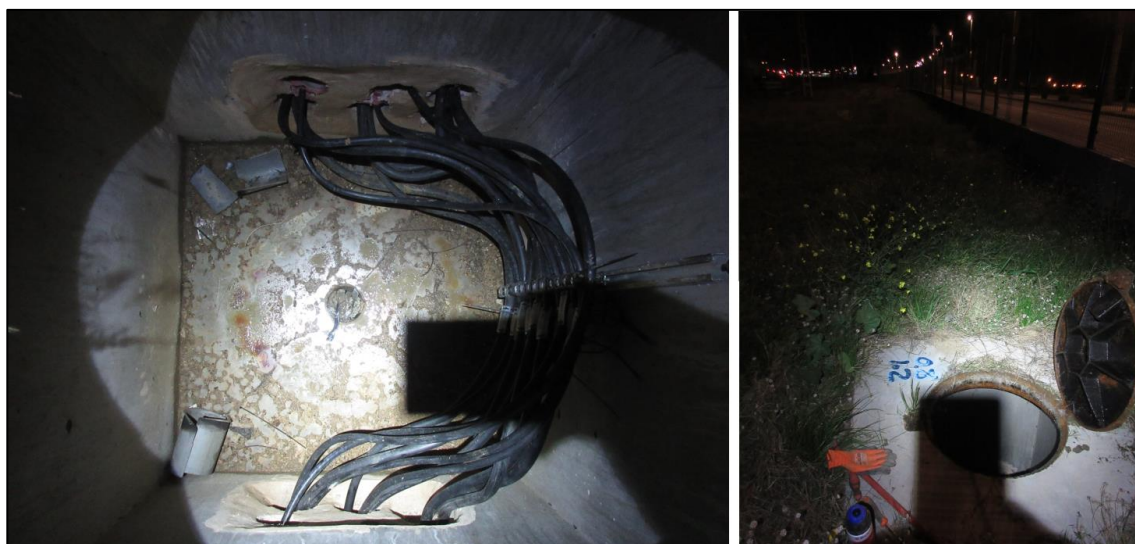
Figura 8: Prisma telecomunicacions ADIF
