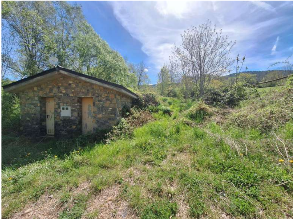
Foto 27: Caseta del depósito y caja de contador en fachada.
