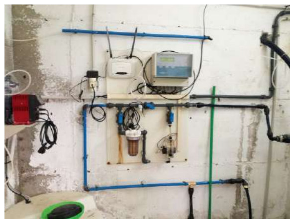
Instalaciones de desinfección
