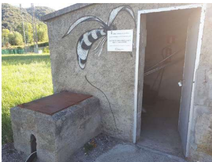
Pozo y caseta cuadro eléctrico y valvulería.
