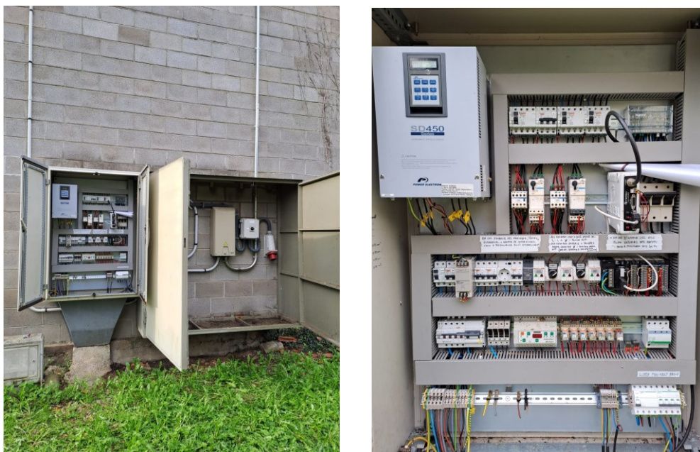
Fotografies del quadre elèctric actual.
