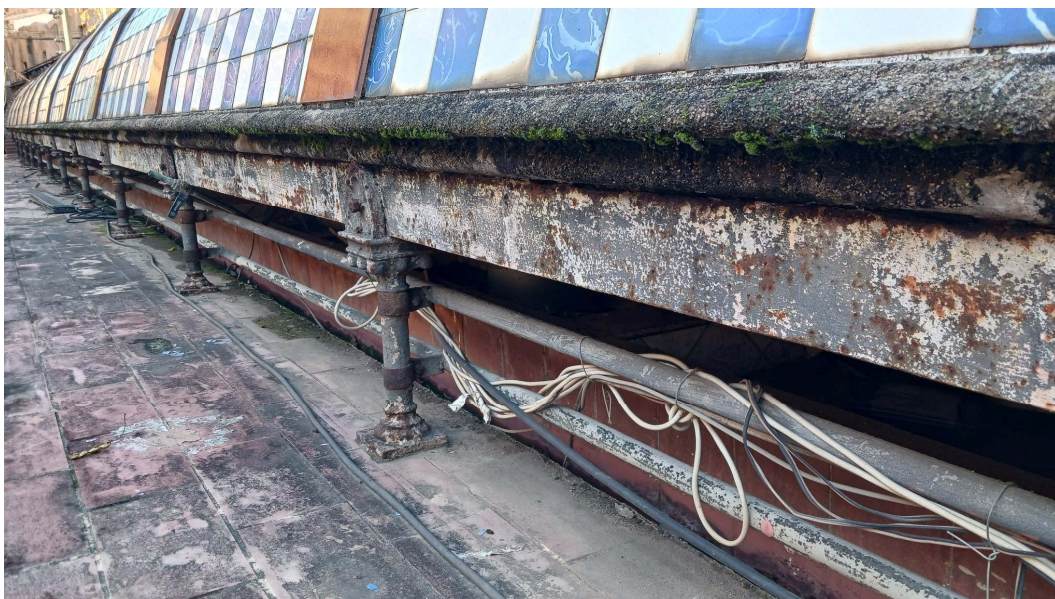
Detall remat pedra a netejar, perfil i elements metàl·lics a sanejar i protegir (endrec instal·lacions)
