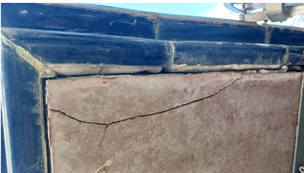
Detall peça marbre Roig Alacant a substituir
