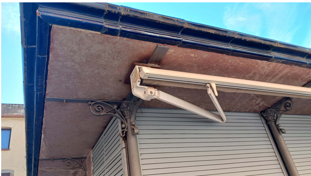
Detall tendals existents i platines afegides a retirar – Elements metàl·lics a restaurar
