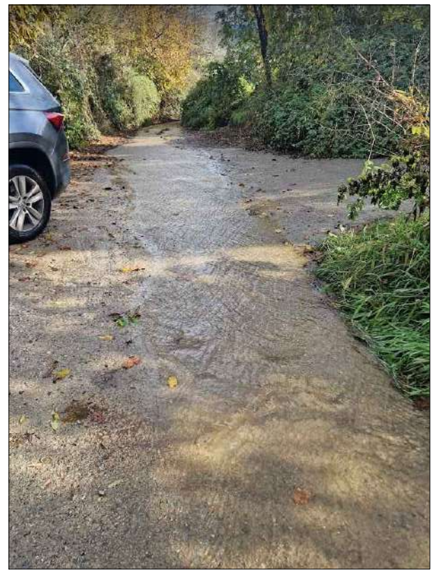
Imatge 03. Aigua que baixa pel camí des del gual colmatat on es desborda. Tota aquesta aigua transcorre pels trams elevats del camí i es drena.
