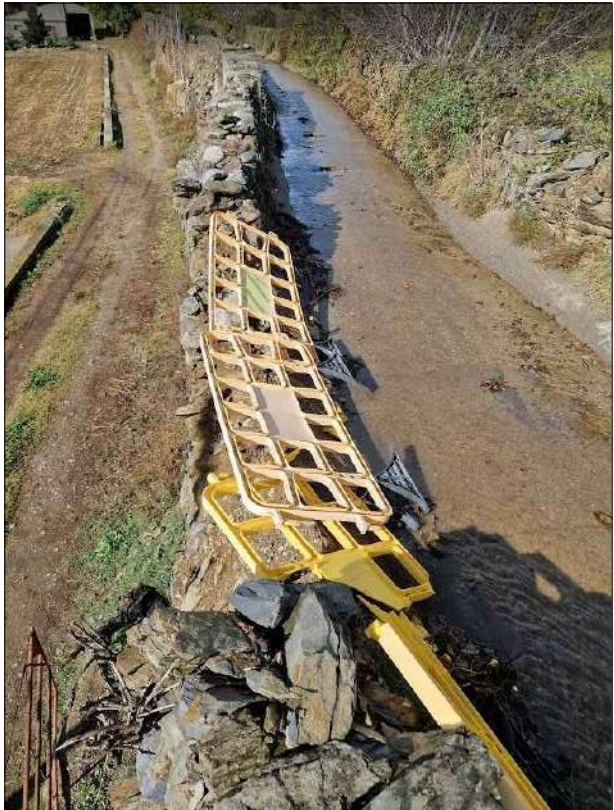
Imatge 01. Estat actual del mur que s'ha precipitat. Vista del camí, sobre el que va en direcció a la granja.
