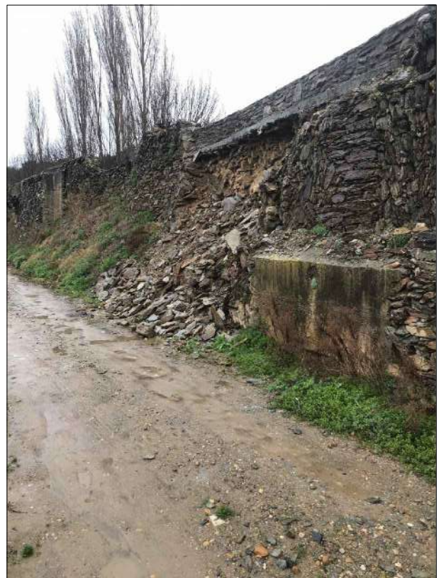
Imatge 03. Vista de l'estat actual del mur des d'un altre punt de vista i des del camí d'accés a la granja, al peu del mur que s'ha precipitat.
