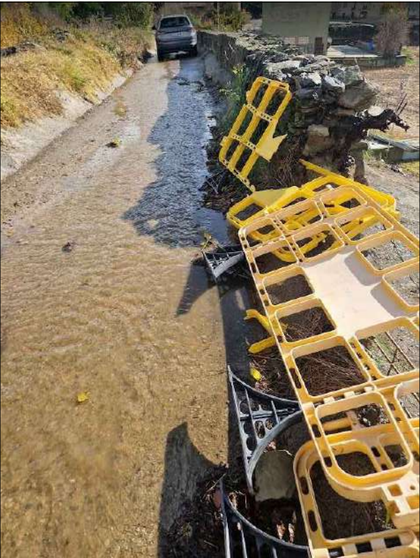
Imatge 02. Estat de detall del tram de mur caigut. El tram afectat ha estat de 5 metres linials però la part de mur a refer és de 12 metres.
