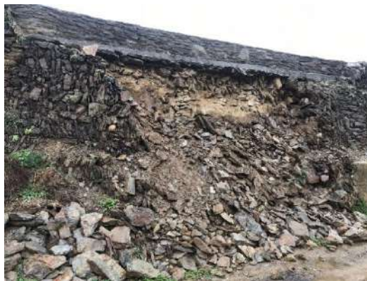
Imatge 04. Estat actual del tram de mur 1. Mur de sosteniment que s'ha precipitat.
