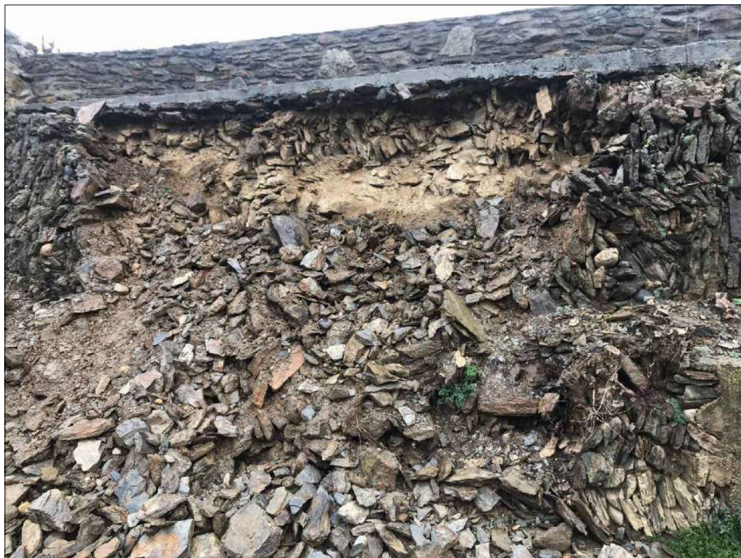
Imatge 02. Estat actual del mur que s'ha precipitat. La longitud del tram directament afectat és de 6 metres, però cal considerar uns metres a banda i banda del tram afectat directament, per evitar desprendiments posteriors per l'alteració del mur de sosteniment.
