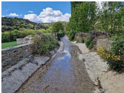
Imatge 03. Estat actual del mur del camí de Benavarre.
