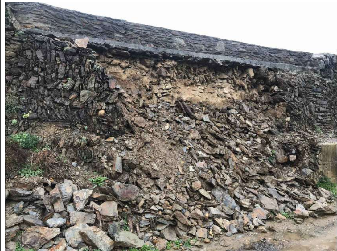
Imatge 01. Estat actual del mur que s'ha precipitat. La longitud del tram directament afectat és de 6 metres, però cal considerar uns metres a banda i banda del tram afectat directament, per evitar desprendiments posteriors per l'alteració del mur de sosteniment.
