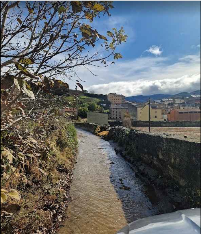
Imatge 03. Vista de l'estat actual del mur des d'un altre punt de vista, amb l'aigua que recorre el camí i es filtra desestabilitzant el talús.
