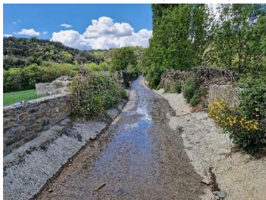
Imatge 04. Estat actual del mur del camí de Benavarre.
