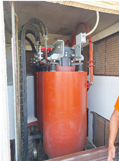
Centre de transformació espatllat
