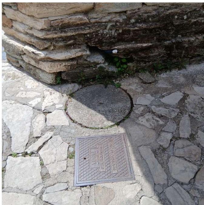
Connexió aigua en carrer principal. Carrer de l'Església
