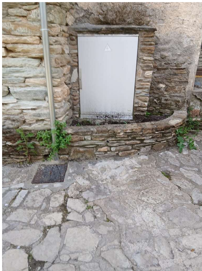
Connexió telecomunicacions en carrer principal. Carrer de l'Església
