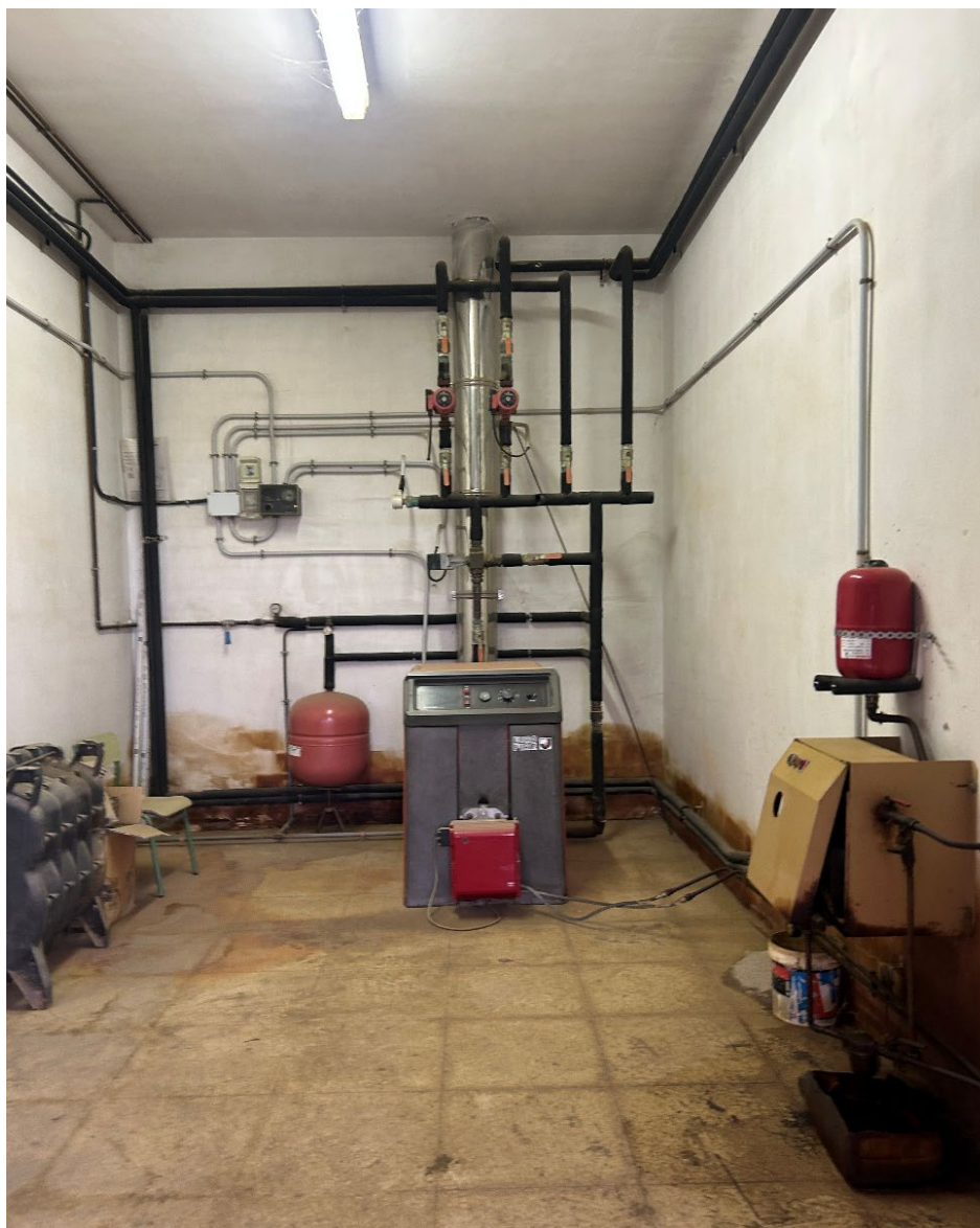
Fotografia 3. Sala de calderes existent
