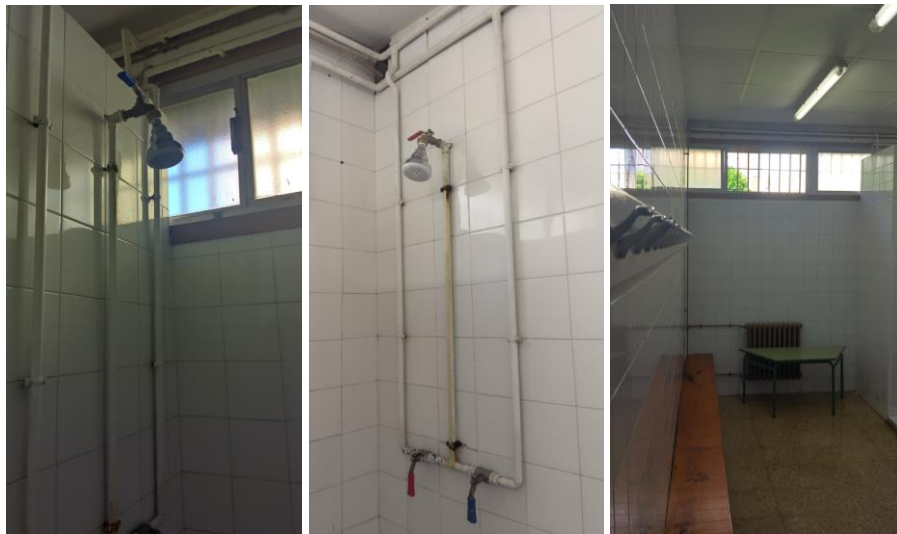
Fig. 5 Aixetes de dutxa inaccessibles i amb mesclat manual d'aigua; espai de vestuari insuficient.
