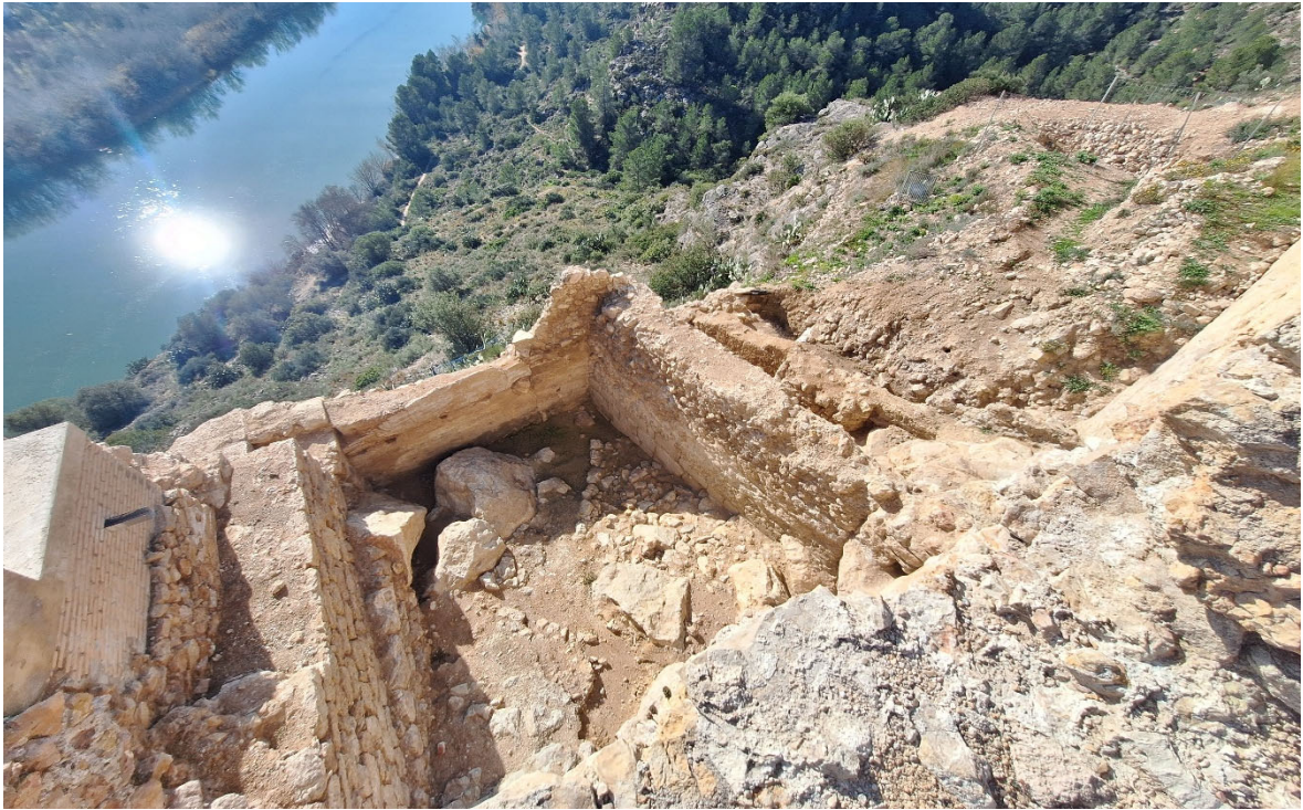
Fig. 3. Impacto ambiental negativo que la zona pendiente de adecuación del bastión de mediodía, con los restos arqueológicos aparecidos pendientes de adecuar, tiene sobre el entorno natural protegido adyacente.
