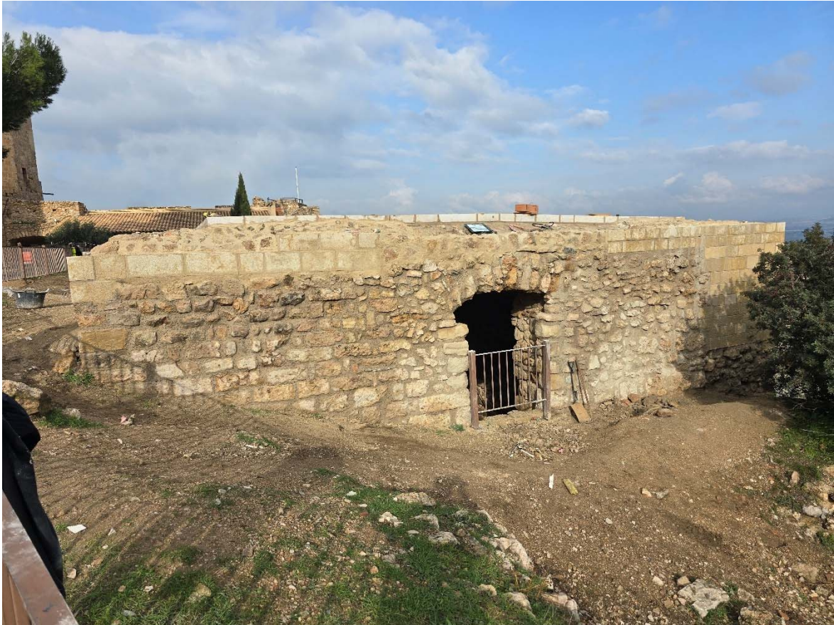
Foto 3. Aspecto más precario que presenta la fachada sur de la misma construcción y su entorno inmediato.
