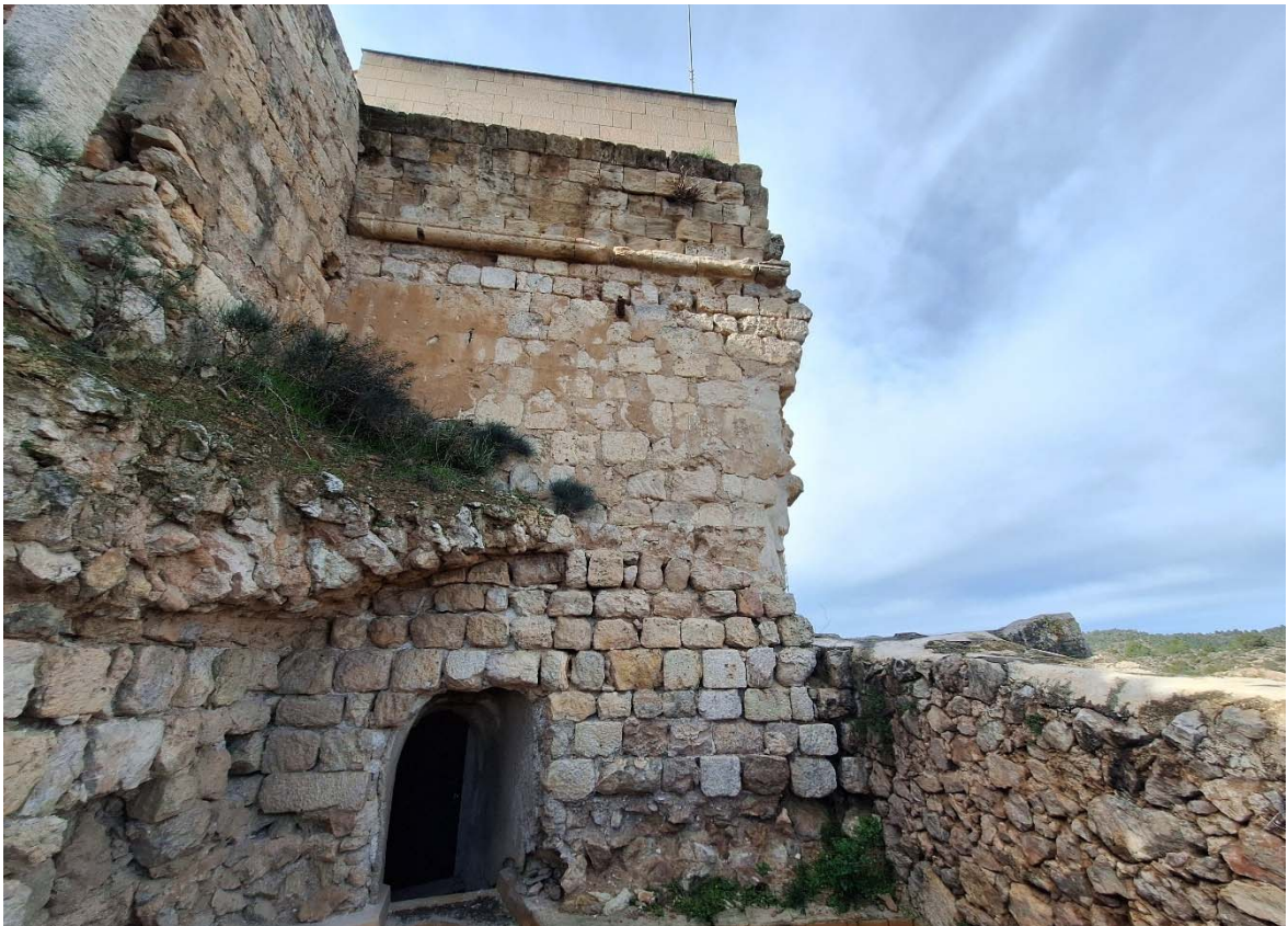
Foto 18. Vista del estado actual del interior de la torre del tesoro.
