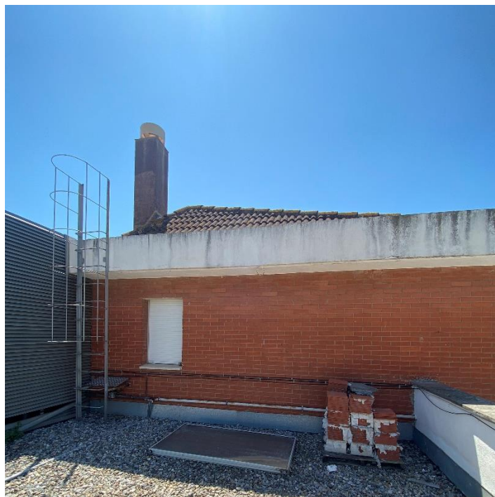
Fotografia 4. Paret on s'ubica l'inversor
