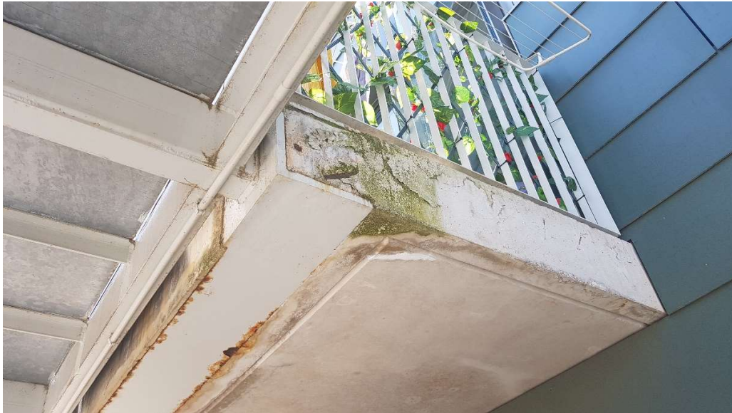
Figura 11. Façana nord. Despreniment de formigó de la cantonada del balcó i oxidació del perfil metàl·lic de connexió entre el balcó i la passera metàl·lica exterior.
