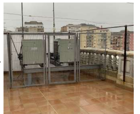
IMATGE UNITATS CLIMATITZACIÓ EXTERIOR
