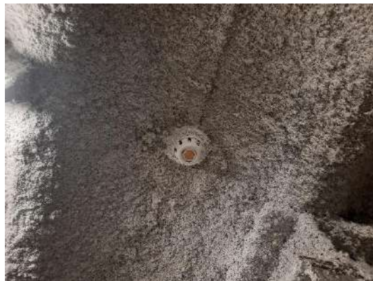
Detectors de fums en sales 1, 2 i 3 i distribuïdor (passadís) de la pl. soterrani
