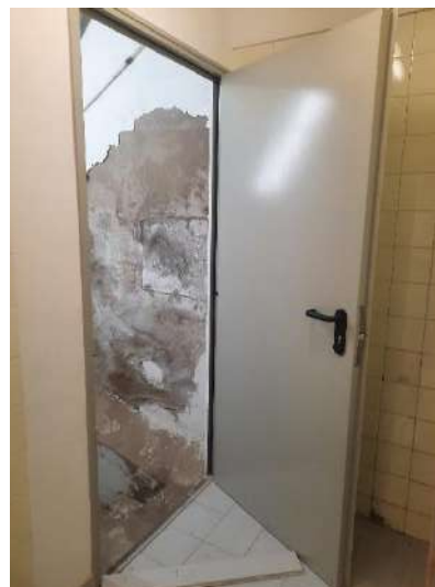
Porta tallafocs d'accés a la pl. soterrani
