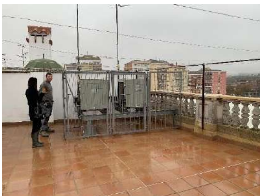
Refredadores existents a la coberta (a substituir)
