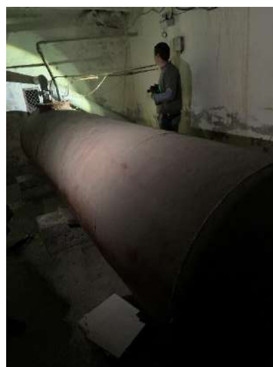
Dipòsit de gasoil existent en pl. soterrani (a suprimir)
