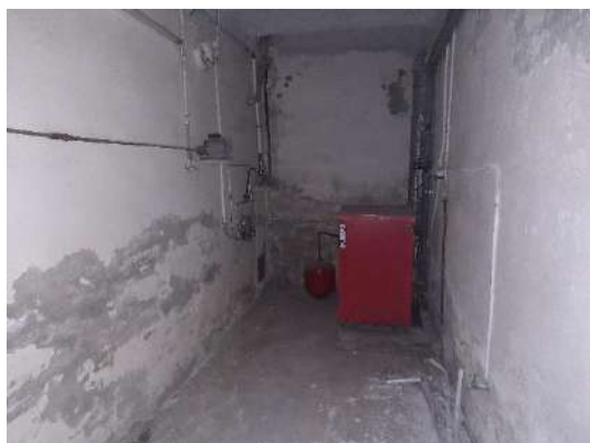
Caldera de gasoil existent en pl. soterrani (a suprimir)
