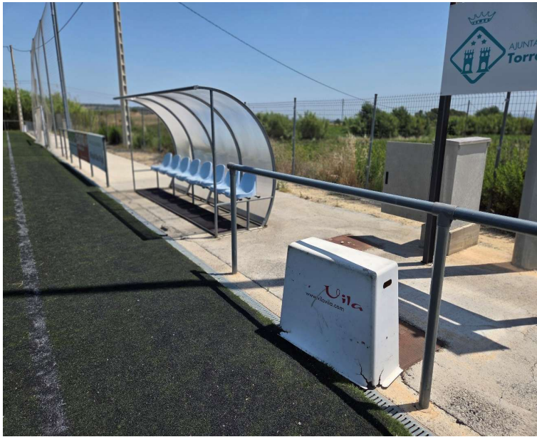
Foto 8. Zona banquetes amb paviment de formigó i es col·locarà gespa. Aspersor tapat amb una caixa de plàstic per evitar cops.
