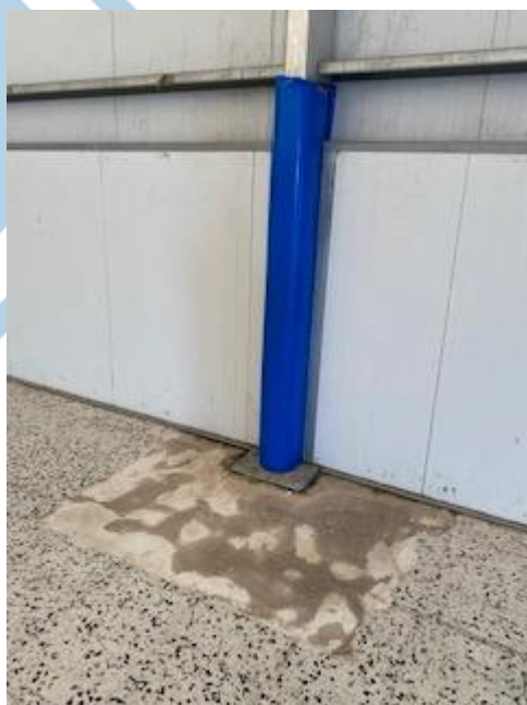
Imatge 3. Filtracions interior pista coberta. Font: Elaboració pròpia.
