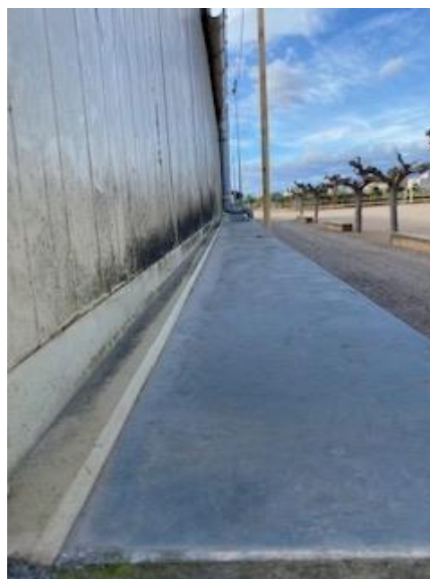
Imatge 4. Humitats exterior mur pista coberta. Font: Elaboració pròpia.
