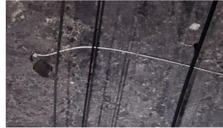
Imatge 3 – Conjunts de suspensió i atirantat existents en els túnels de la Bauma, Castellbell i Firmat
