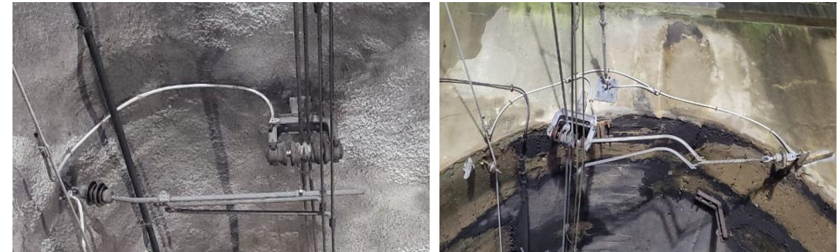
Imatge 2 – Presència d'òxid als túnels.
