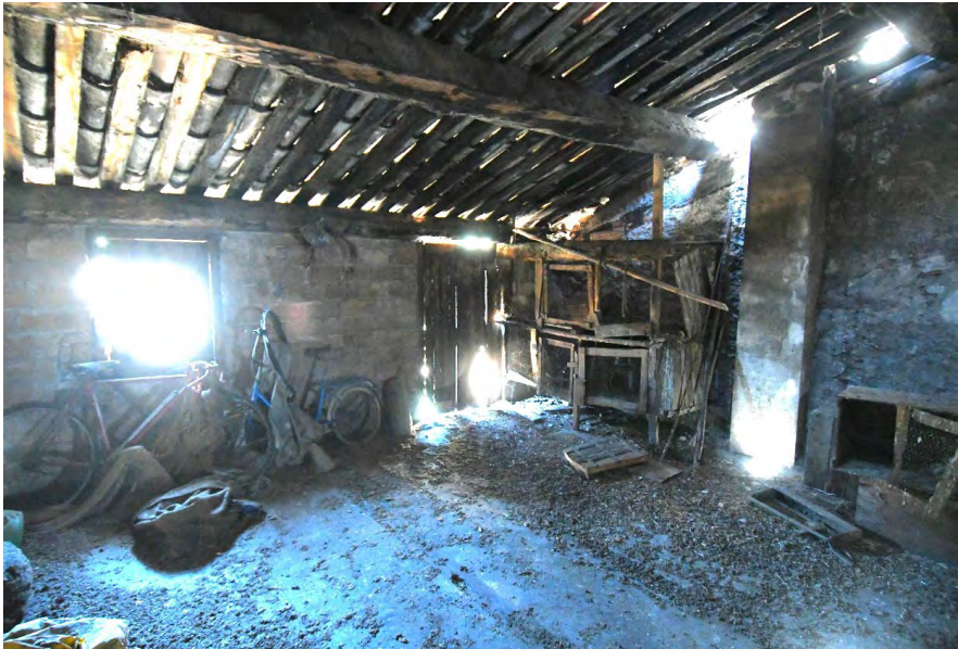
Estat de la teulada, on es fa evident la desconexió entre les teules, amb la conseqüent presència de degoters sobre el forjat de pis.
