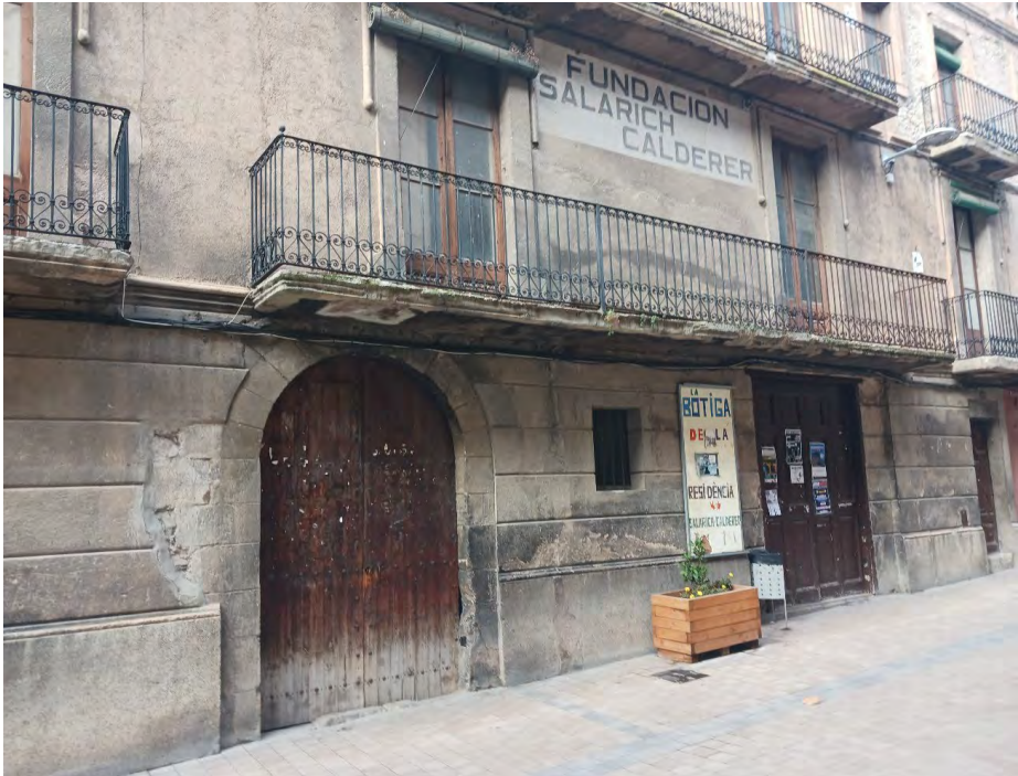
Façana principal, amb un agreujament de la degradació estructural de les llosanes i les motlures, de les llosanes de balcó.
