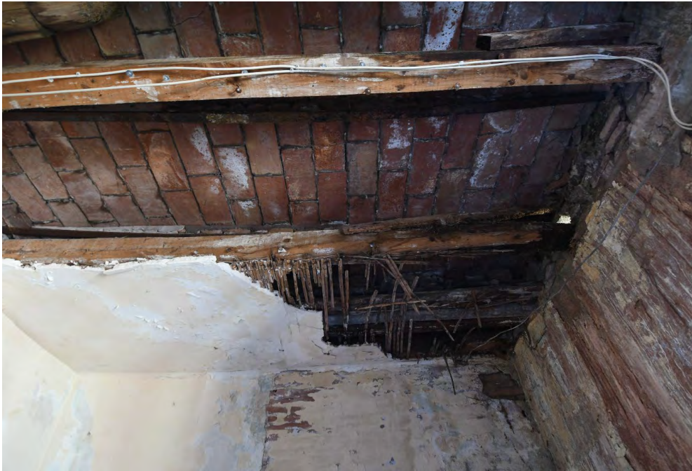
Estat del sostre i cel-ras del segon pis, amb greus filtracions en el mur de façana.
