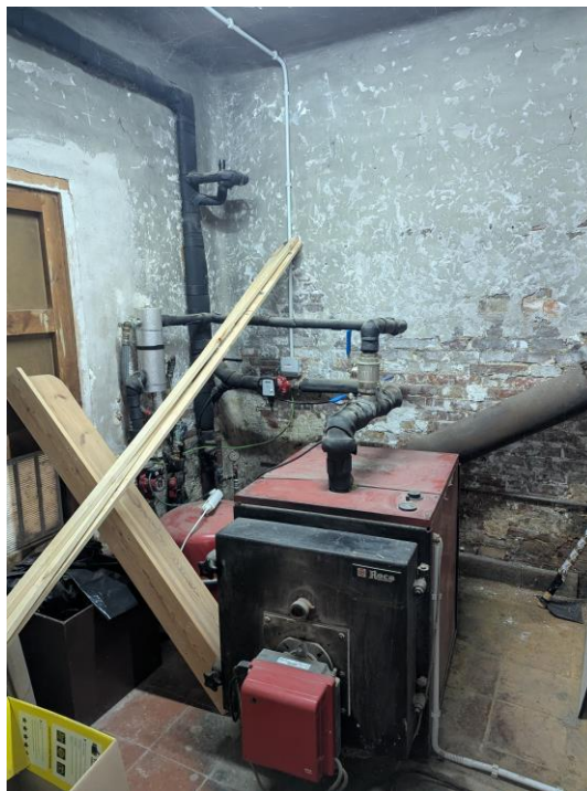
Instal·lació interior de la sala de calderes
