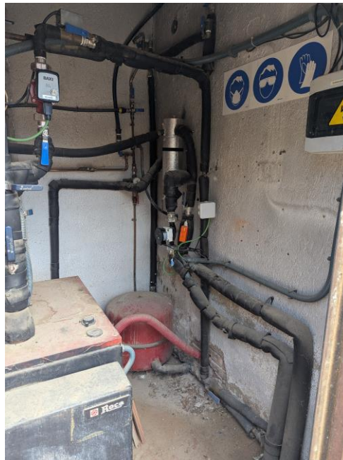
Instal·lació interior de la sala de calderes
