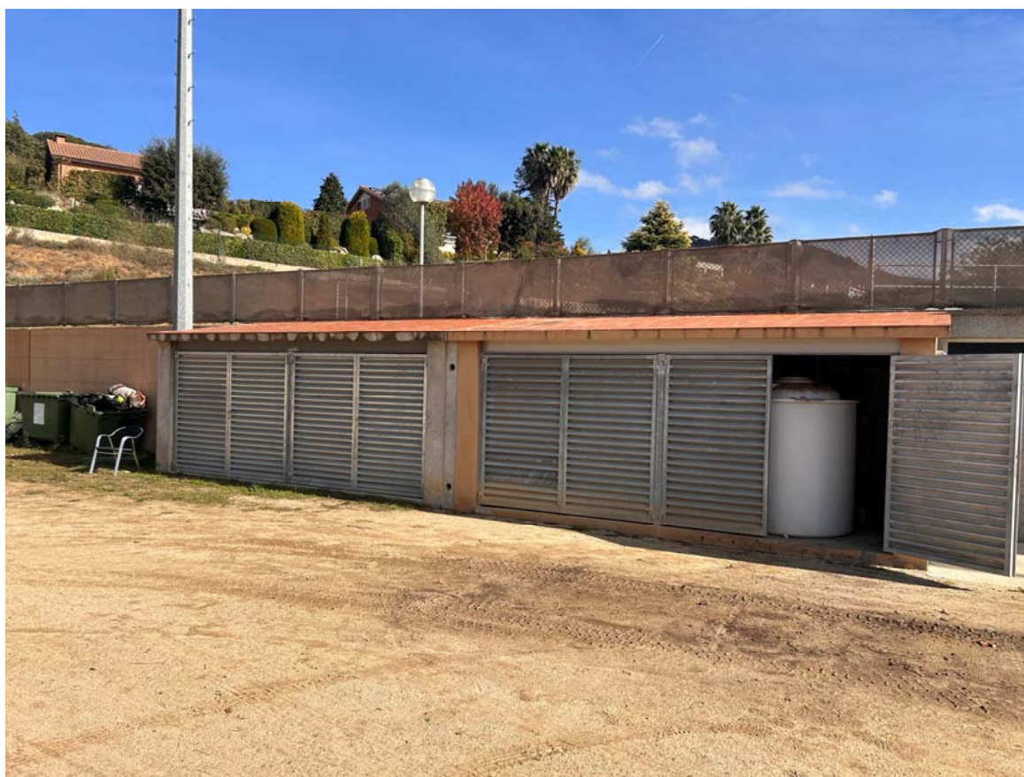
Exterior caseta filtratge i de producte químic
