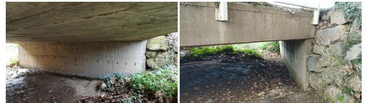
Figura 3. Detall de l'estat actual de la part inferior de la llosa de formigó (esp) i de l'estrep i protecció d'escullera (dreta) del pont del Barri de l'Estació.
