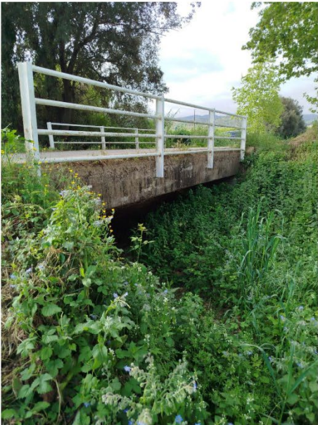
Costat nord pont, ple de vegetació
