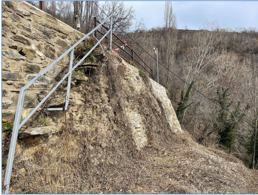
Il·lustració 4 .Il·lustració 4 Imatge on es veu la desplomada que té el mur actual.
