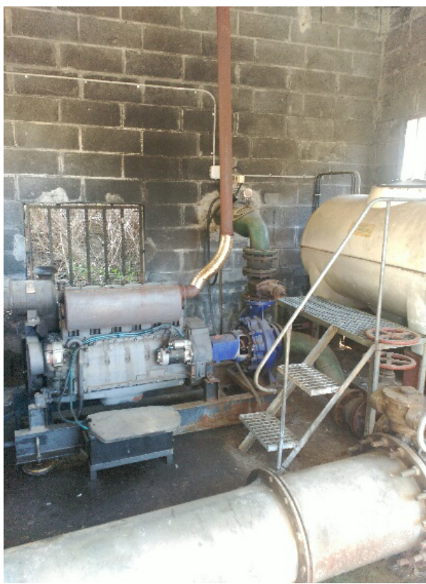
Foto nº 5.- Vista de l'equip actual de bombeig amb grup electrogen, el qual es pretén electrificar.
