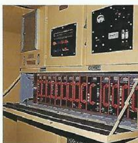
Armari de control dins de la cabina
