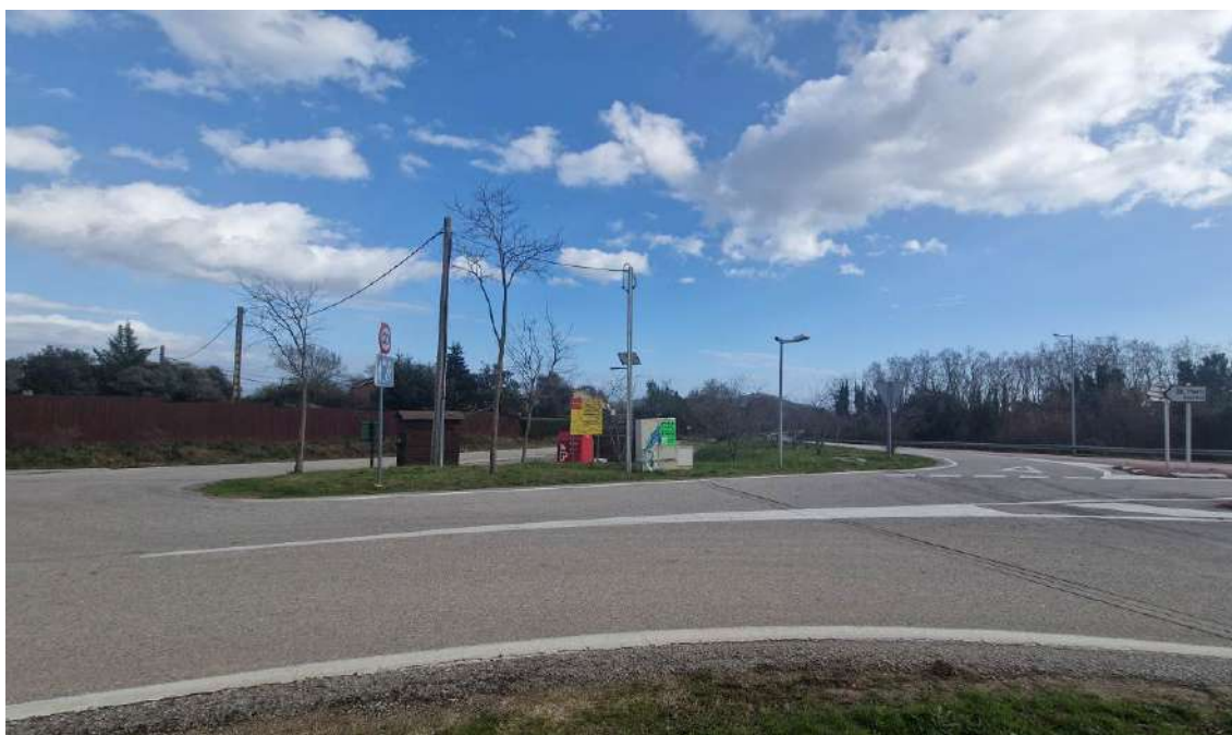
Imatge 29. Just a l'entrada hi trobem l'escomesa i quadre de control de l'enllumenat així com diversos fanals de caràcter viari i sempre enfocats a la C63.
